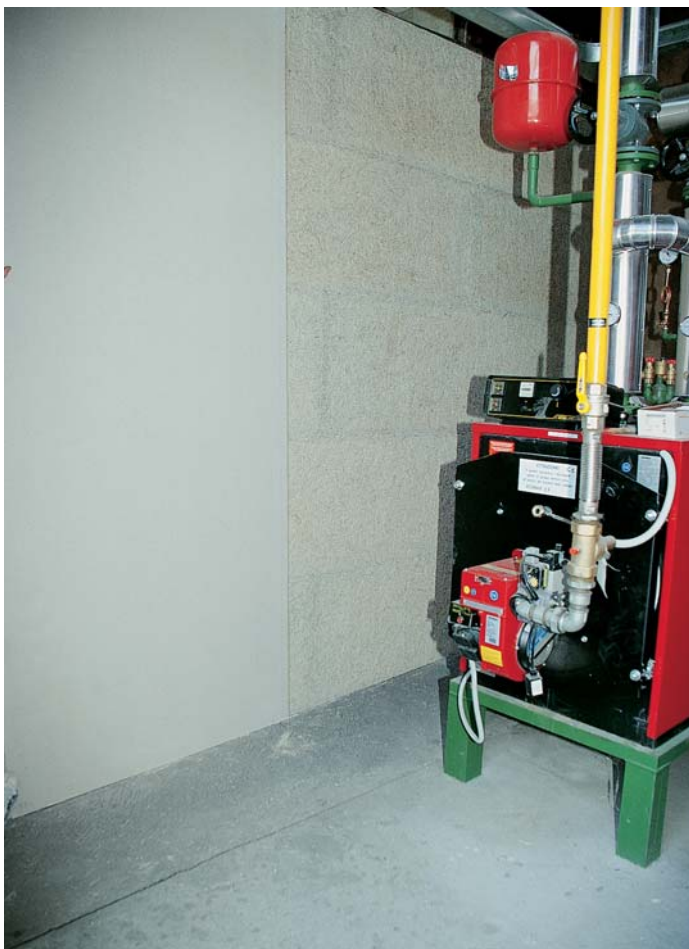
Locale caldaia con parete rivestita con pannelli Celenit CG/F
